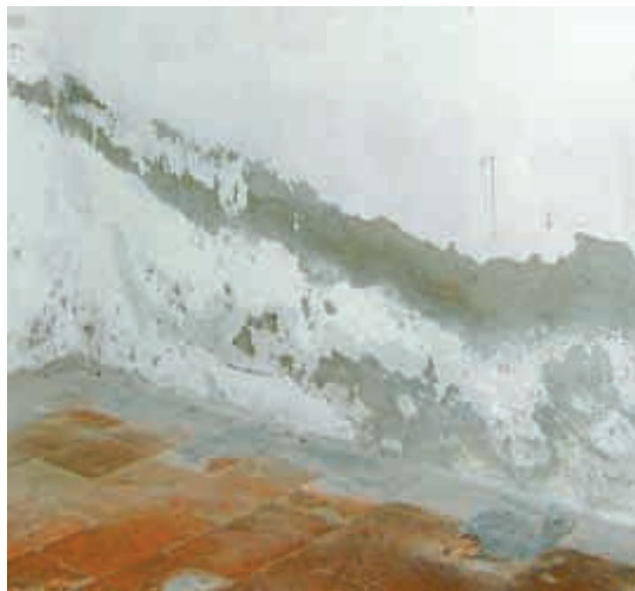
Bauschäden: Die Mangelhaftigkeit des Bauwerkes ist Voraussetzung für die Ausübung von Mängelrechten wie Nachbesserung, Minderung, Wandlung und Schadenersatz. Bilder: HEV
